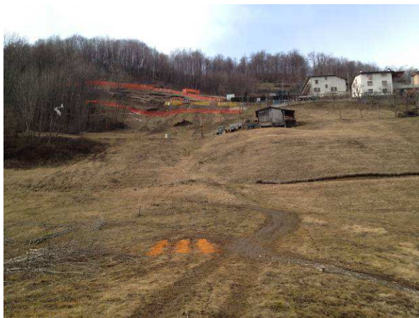
Figura 4 - Vista dal torrente della zona soggetta a frana e dei lavori di ripristino del tratto stradale di accesso al nucleo abitato visibile sulla destra
